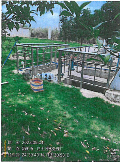
污水厂进水口
