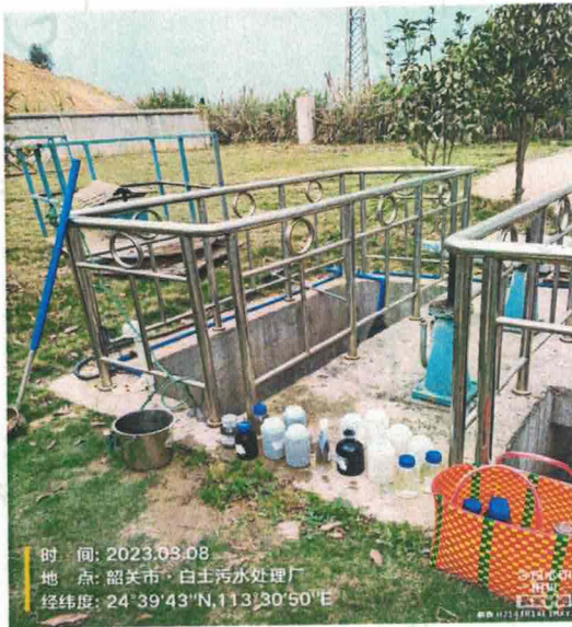
污水厂进水口
