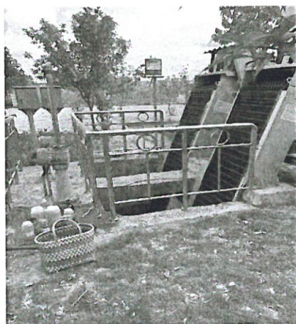
污水厂进水口
